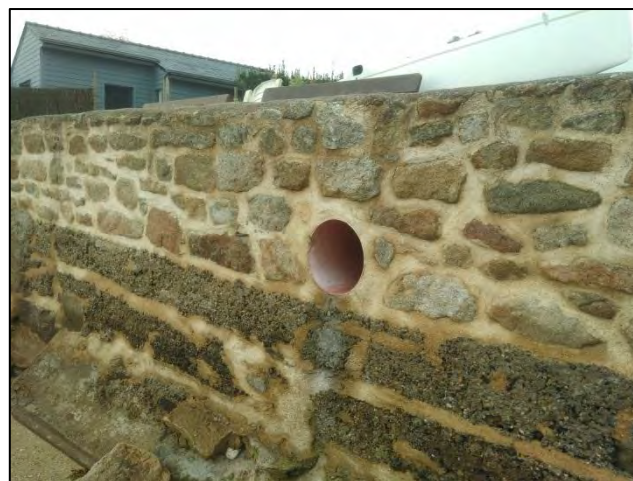
Figure 35 : exutoire pluvial de la plage de Port Miquel
